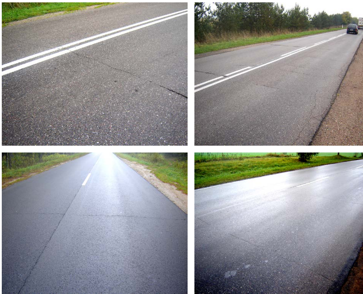
Rys. 6. Przykłady spękań niskotemperaturowych zaobserwowane w trakcie badań terenowych
