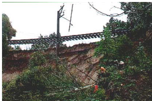
Ryc. 4. Obsunięcie ziemi na trasie kolejki podmiejskiej w okolicach miejscowości Swiętłogorsk
