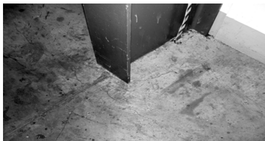
Ryc. 6. Uszkodzenia posadzki wskutek braku dylatacji na styku z elementem nośnym hali
