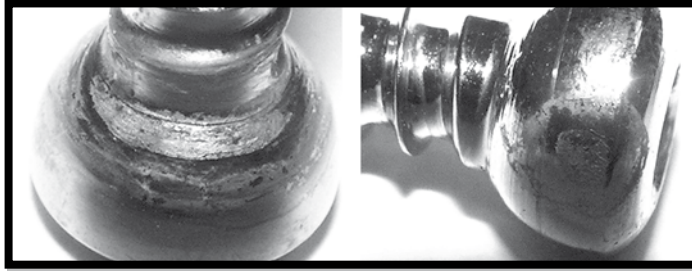
RYS. 3. Zniszczenia korozyjne na powierzchniach śrub. FIG. 3. The corrosion failure on the screws surface.
