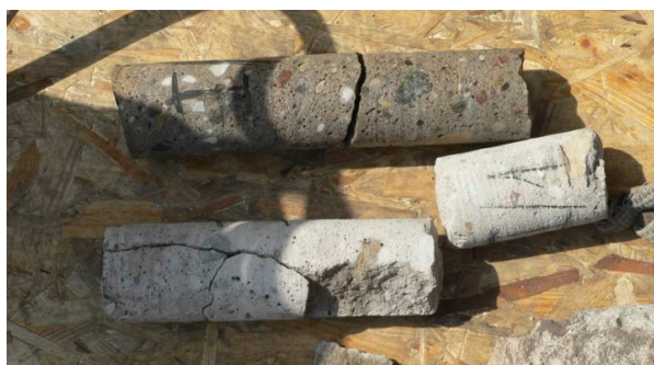
Rys. 5. Wewnętrzne pęknięcia betonu elementów żelbetowych stwierdzone na odwiertach pobranych do badań laboratoryjnych (fot. A. Radzicki).
