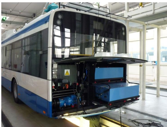
Rys. 2. Baterie trakcyjne trolejbusu Solaris Trollino 12 / Medcom należące do PKT Gdynia
