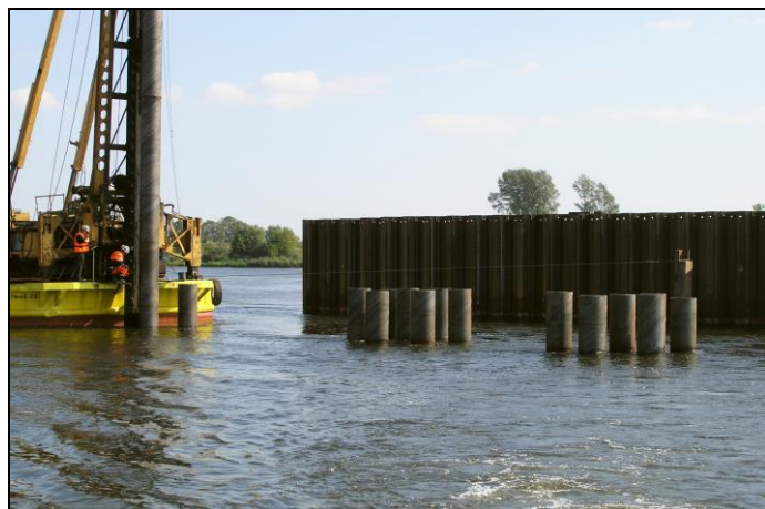
Rys. 10. Pale rurowe podpory tymczasowej mostu w Grudziądzu. W tle widoczna ścianka szczelna osłaniająca podporę stałą mostu
