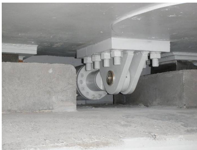
Rys 6. Tłumik hydrauliczny zamocowany na obiekcie
