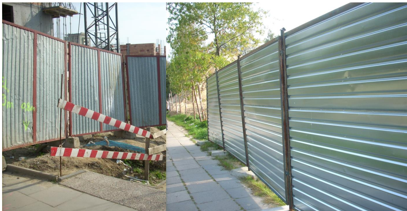
Fot 2. Ogrodzenia placu budowy wykonane w tej samej technologii różniące się estetyką wykonania. Fot. R. Okraszewska 2010
