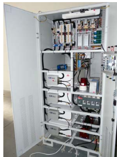
Rys. 3. Zasobnik superkondensatorowy zainstalowany w trolejbusowej podstacji trakcyjnej Północna w Gdyni; a – schemat rozmieszczenia aparatury, b – widok aparatury (1 – moduły superkondensatorowe, 2 – przekształtnik DC/DC wraz z układem sterowania, 3 – moduł zabezpieczeń i filtra wejściowego, 4 – moduły superkondensatorowe przewidziane do instalacji w przyszłości).
