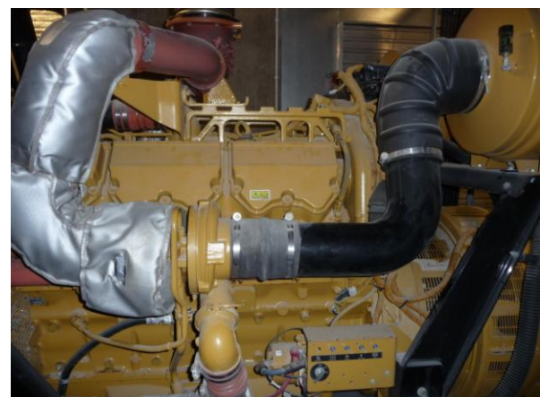
Rys. 4. Widok środkowej części zespołu spalinowo-elektrycznego o mocy 1000 kVA zainstalowanego w PGE Arena Gdańsk
