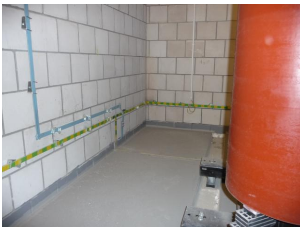
Rys. 5. Przewody uziemiające w stacji transformatorowej
