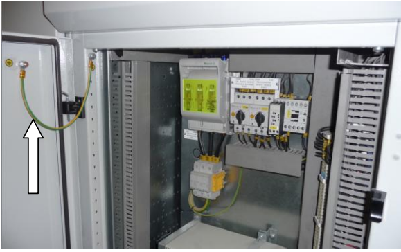
Rys. 8. Połączenie elementów rozdzielni wykonane przewodem giętkim
