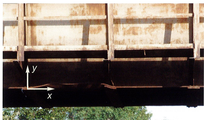
Deformacje pionowe krawędzi pasa dolnego
