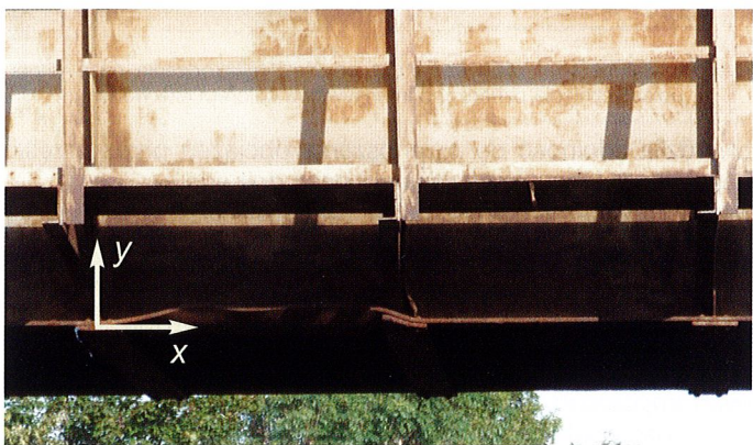
Deformacje pionowe krawędzi pasa dolnego
