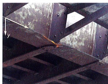
Deformacje pionowe krawędzi pasa dolnego
