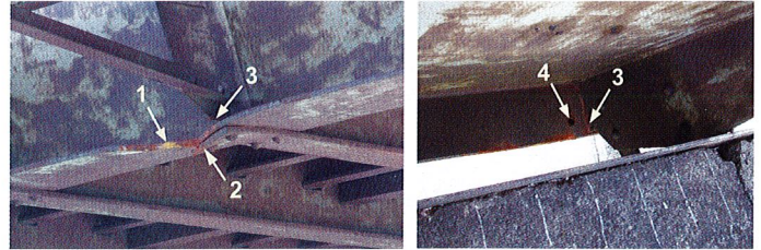
Rys. 7. Uszkodzenia dźwigara od strony Gdańska: 1 – deformacja pasa dolnego dźwigara głównego, 2 – deformacja pasa dolnego poprzecznicy, 3 – zniszczone połączenie spawane żebra z pasem dolnym dźwigara, 4 – ścięty nit połączenia pasa poprzecznicy z dźwigarem
