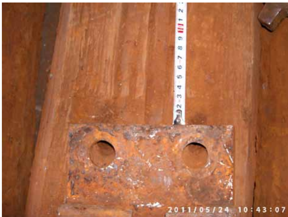
5. Fotografia szczegółów – przykład ułożenia przymiaru w celu pokazania wielkości przesunięcia podkładki żebrowej
