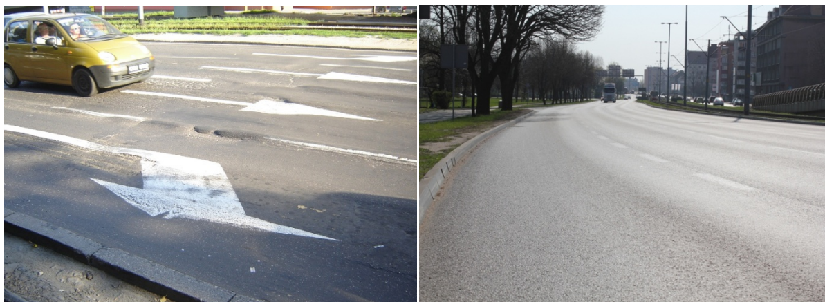
Fot. 1. Stan techniczny ulicy Podwale Przedmiejskie na której zastosowano beton asfaltowy o wysokim module sztywności z asfaltem 20/30
