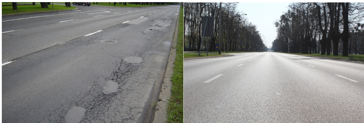
Fot. 2. Stan techniczny Alei Zwycięstwa na której zastosowano beton asfaltowy o wysokim module sztywności z asfaltem 20/30
