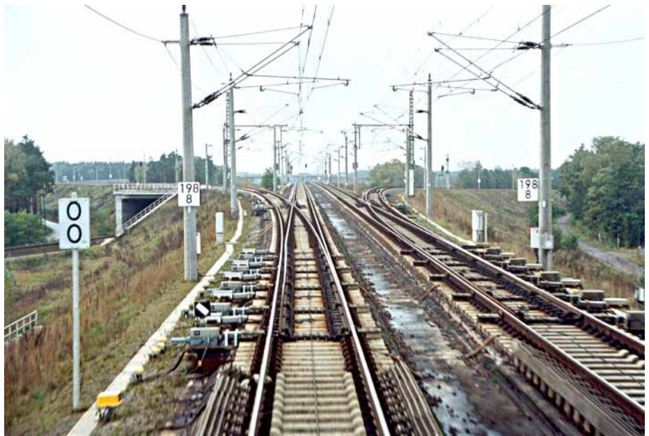
6. Odgałęzienie toru na linii wielkiej prędkości wykonane za pomocą rozjazdu 4800/2450 1:24,26 [10]
