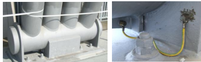
Rys. 8. Widok przegubu łączącego dźwigar zadaszenia z systemem uziemieniowym stadionu, widoczny mostek zwierający elektrycznie części ruchome [fot. D. Kowalak]
