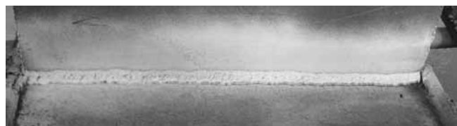
Rys. 5. Złącze próbne 1BW. Widoczne podtopienie i nierówne lico spoiny
