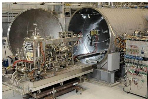
Rys. 3.13. Generator prądu opracowywany przez NASA do wykorzystania na Księżycu, Silnik Stirlinga zasilany będzie energią cieplną z reaktora jądrowego [8]
