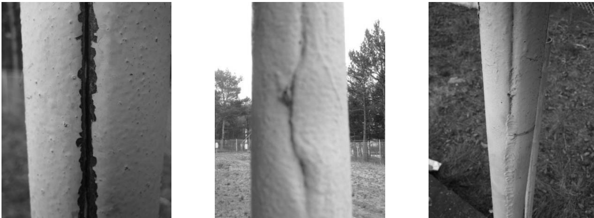
Rys. 7. Rura w miejscu szwu podłużnego
