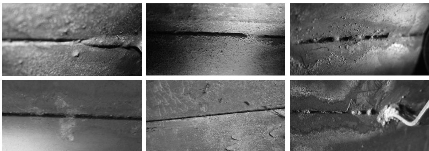
Rys. 6. Przykłady wadliwie wykonanych spoin czołowych łączących połwki segmentów wieży
