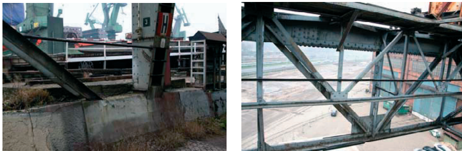
Rys. 3. Typowe stwierdzone uszkodzenia konstrukcji
