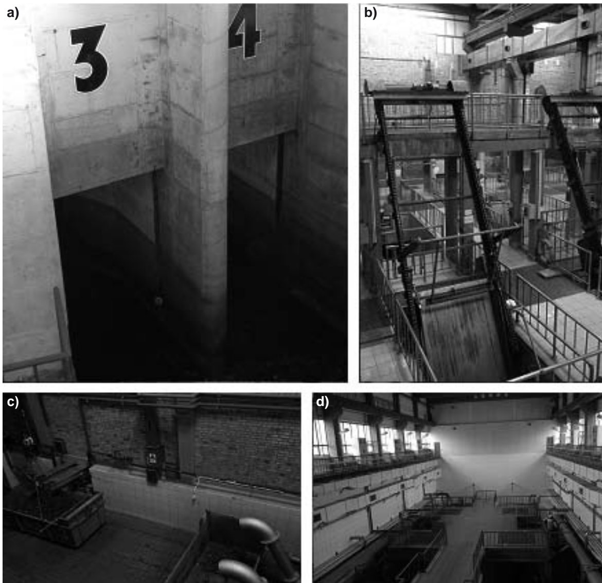
Rys. 7. Początek ciągu technologicznego a) komora rozdziału (włączony ciąg nr 3 i nr 4), b) kraty, c) skratki, d) przepompownia ścieków surowych
