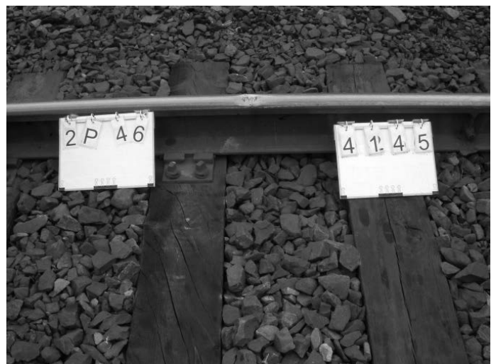
Rys. 8. Wada squat – brak przytwierdzenia szyny do podkładu
