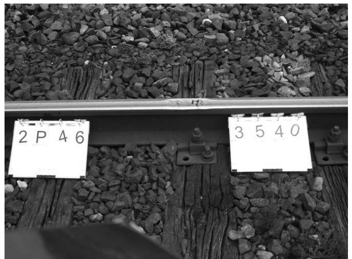
Rys. 7. Wada squat – zły stan podkładów, przytwierdzeń i podsypki
