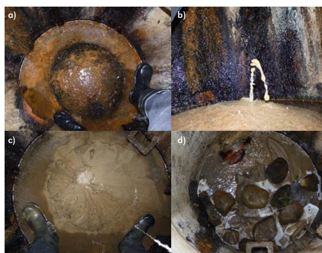
Rys. 12. Studnia z zakolmatowaną geowłókniną: a) stan zastany, b) wypływ wody przez rozdarcie, c) upłynięcie podłoża pod studnią, d) doraźne zabezpieczenie przed wynoszeniem podłoża
