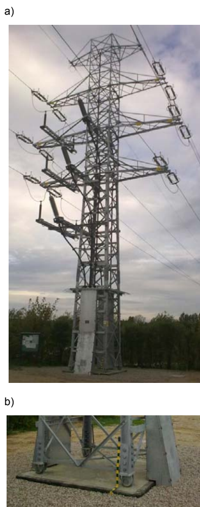
Rys.6. Widok: a) kompletnego słupa kablowego, b) powierzchni gruntu w bezpośrednim sąsiedztwie słupa
