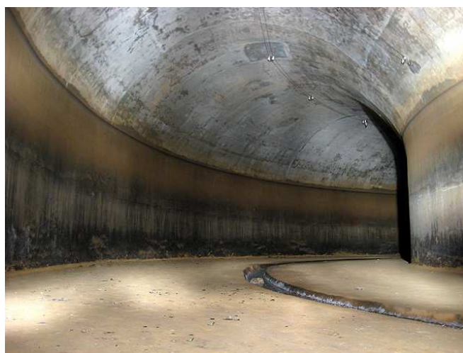
Rys. 1. Komora K1, środkowy pierścień zbiornika, pod sklepieniem widoczne przewody prowadzone na izolatorach
