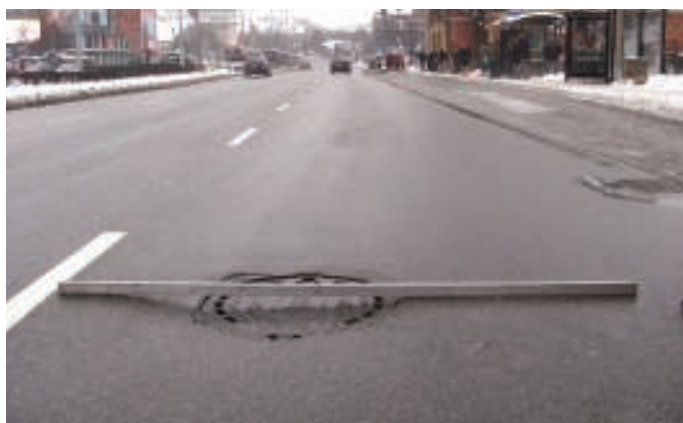
1. Przykład zapadniętej studni kanalizacyjnej zlokalizowanej na odcinku ulicy Podwale Grodzkie w Gdańsku
