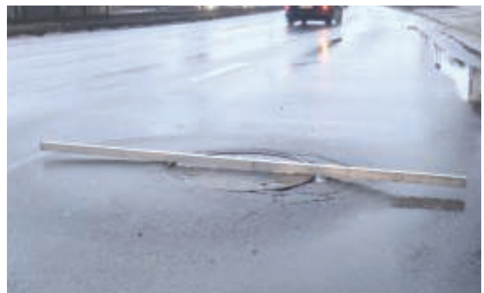
2. Przykład wyniesienia studni kanalizacyjnej powyżej sąsiadującej z nią konstrukcji nawierzchni na odcinku ulicy Podwale Przedmiejskie w Gdańsku
