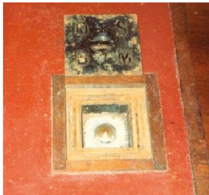
Rys. 6. Reper operacyjny zainstalowany w budynku Stacji Newlyn [31]
