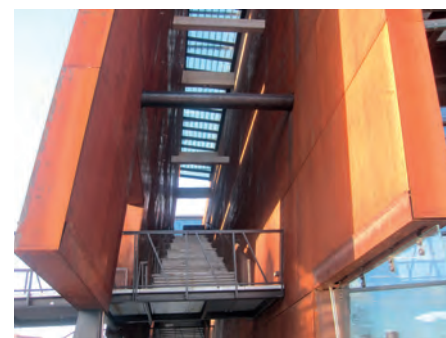
Rys. 5. Fasada obiektu użyteczności publicznej ze stali odpornej na korozję atmosferyczną – ECS Gdańsk
