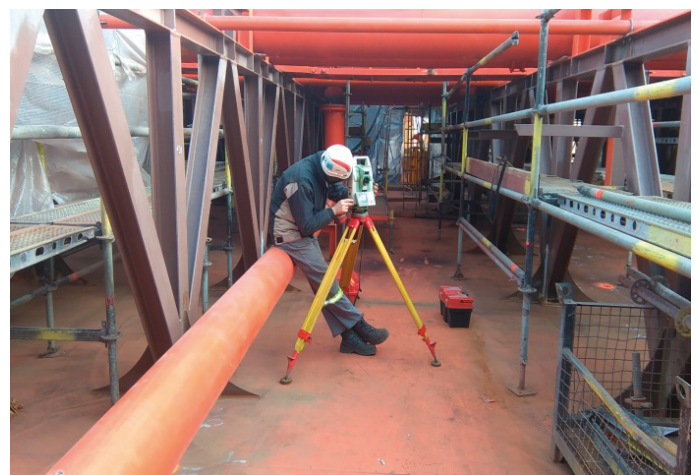
Rys. 6. Prace przygotowawcze do pomiarów geodezyjnych na pokładzie budowanej konstrukcji (fot. Firma U-H DIAZ)
