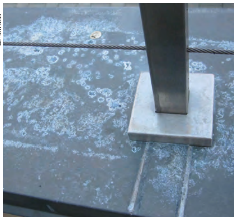
Rys. 6. Wykwity białej korozji cynku na blachach tytanowo-cynkowych
