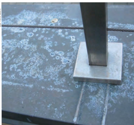
Rys. 6. Wykwity białej korozji cynku na blachach tytanowo-cynkowych
