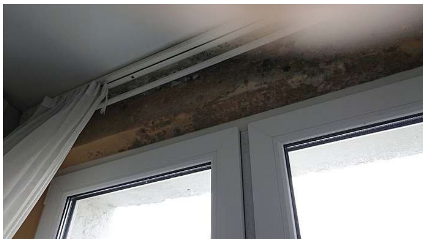
FOT. 4. Uszkodzenia ciepłno-wilgotnościowe w pokoju pomiędzy pokojem przyległym do ściany szczytowej a kuchnią (PP) w lokalu mieszkalnym w poziomie kondygnacji XI piętra budynku; fot.: archiwum autora
