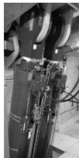
Fot. 2. Dźwigniki hydrauliczne (kładka w pozycji otwartej)
