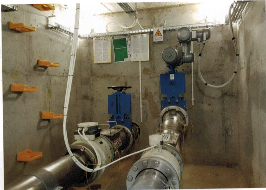
Fot. 3. Komora pomiarowa
