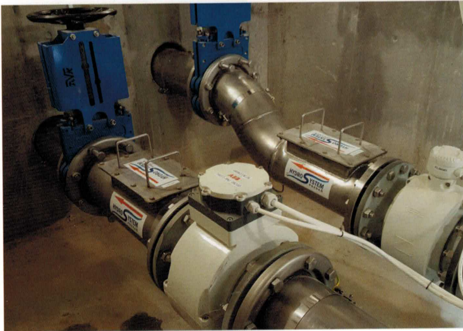
Fot. 2. Komora pomiarowa
