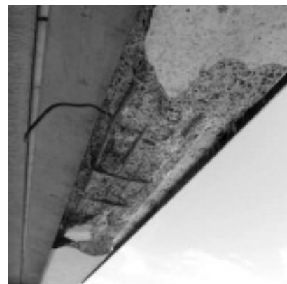
Fot. 1. Ubytki w dźwigarze skrajnym
