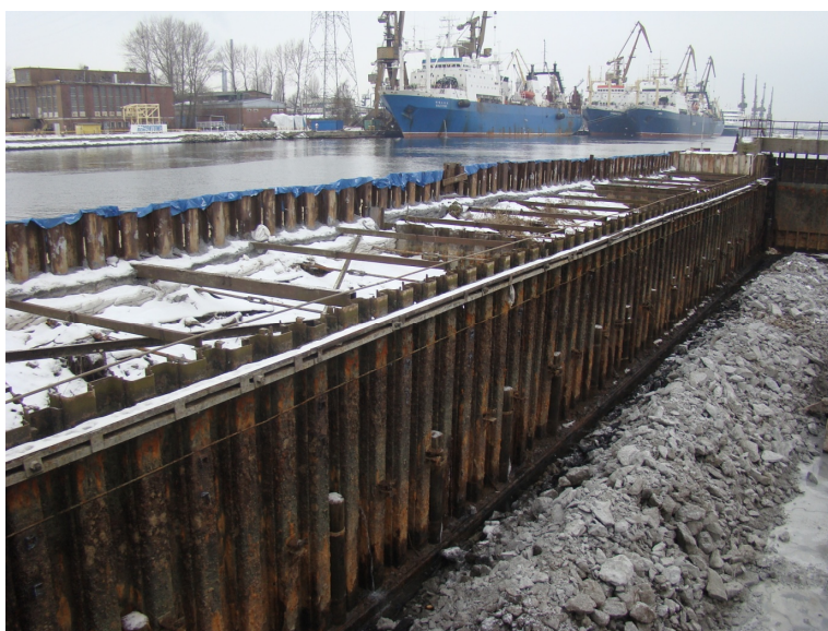
Rys. 3 - Widok komory zachodniej doku i grodzy zewnętrznej grodzy od strony kanału po rozpoczęciu rozkuwania płyty dna doku. Fot. własna
