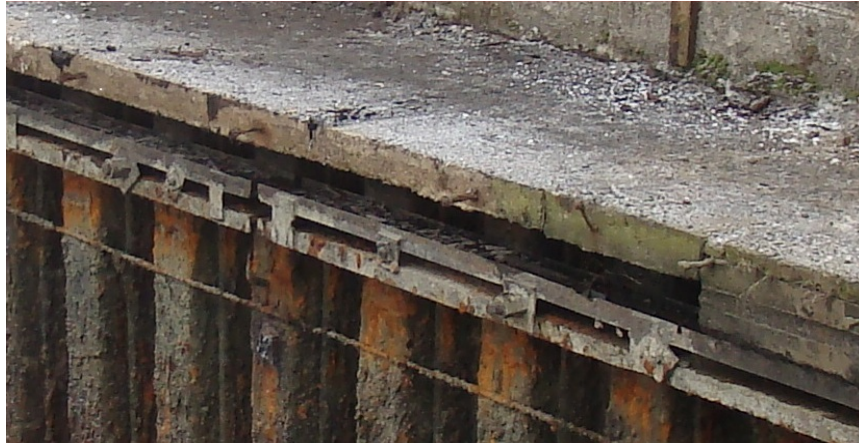
Rys. 6 - Korozja ścianki Nabrzeża Przemysłowego. Fot. własna
