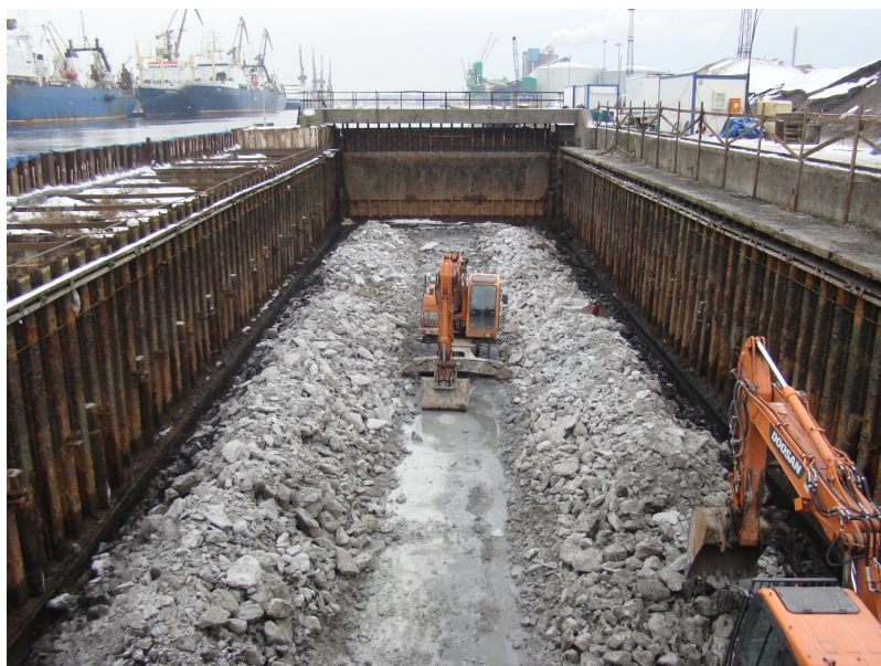
Rys. 9 - Widok osuszonej zachodniej komory doku po rozpoczęciu robót rozbiórkowych rzędna dna - 4,82 m n.p.m. Na wprost widoczna brama doku, po prawej stronie skorodowana ścianka szczelna Nabrzeża Przemysłowego, po lewej stronie ścianka grodzy zewnętrznej. Fot. własna
