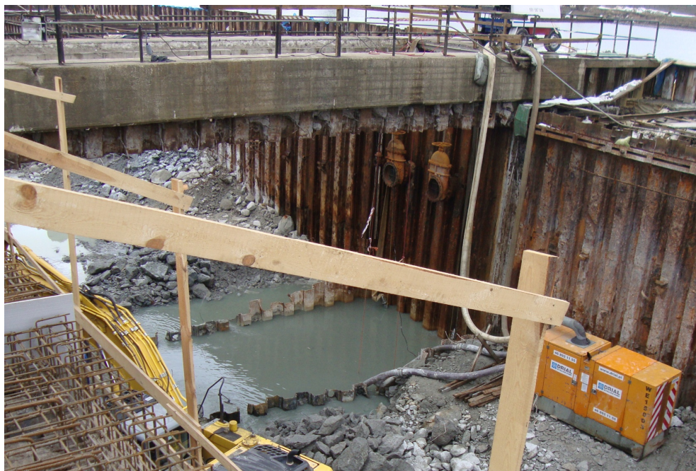
Rys. 10 - Widok komory pomp po wycięciu ścianek szczelnych do poziomu dna grodzy wykorzystywanej, jako duża studnia odciążająca po udroźnieniu jej dna. Fot. własna
