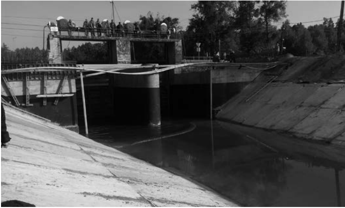
Rys. 8. Końcowa faza remontu w części poniżej zwierciadła wody w kanale – rozpoczęcie napełniania kanału 15.09.2014 roku – rejon jazu mostowego (fot. J. Haftka)
