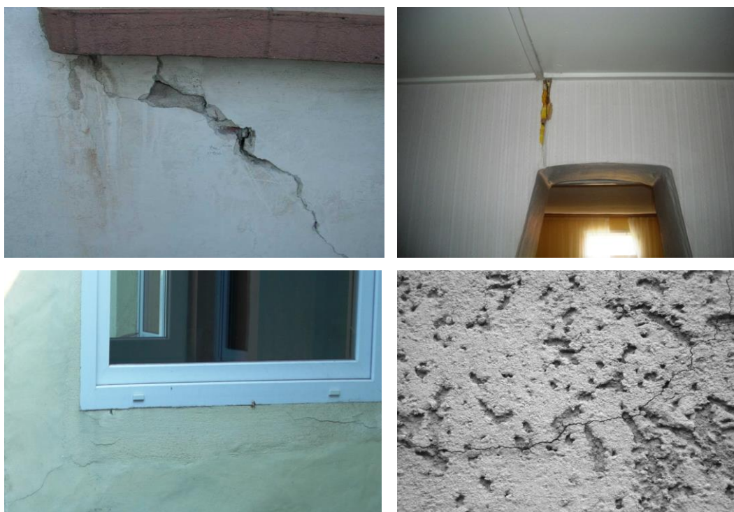
Rys. 2.1. Uszkodzenia powstałe na skutek drgań komunikacyjnych.
