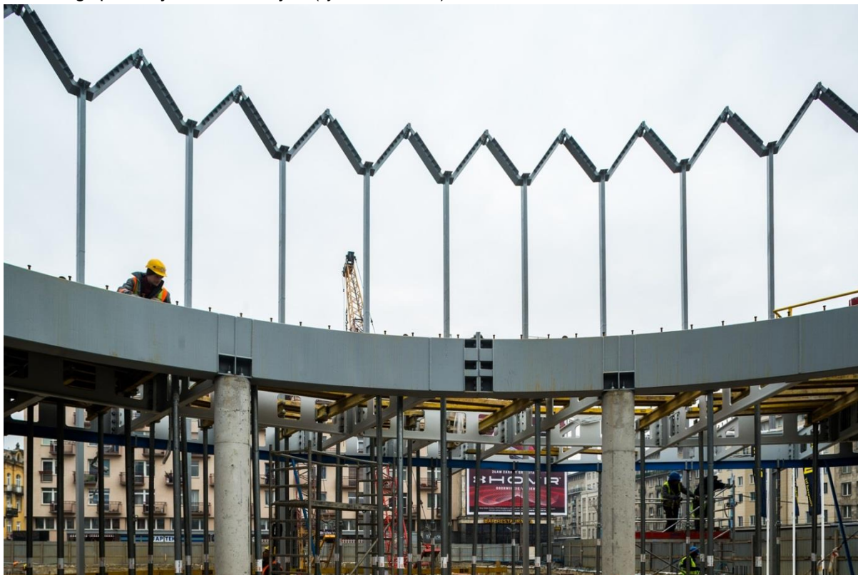
Rys. 17. Pierścień nośny ruszta antresoli i nośne słupy fasadowe po obrysie nowej Rotundy
