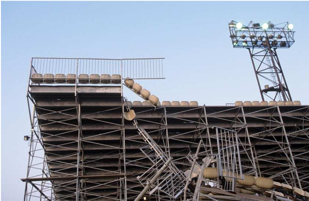
Fot. 1.4 Awaria tymczasowej konstrukcji trybuny na Korycycy w 1992 roku ( http://www.stadiumguide.com ).
