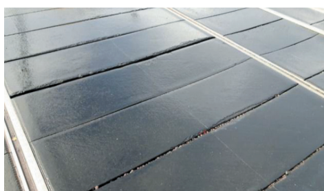
Fot. 4. Uszkodzenie sprężenia przejazdu z płyt gumowych Źródło: materiały własne
