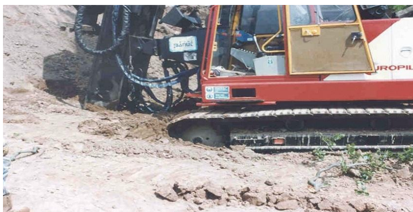
Fotografia 1.1 Palownica „tonąca” z powodu złego zagęszczenia materiału platformy roboczej (PFSF, 2008)
