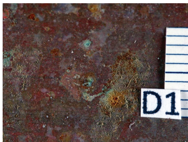
Rys. 3. Ten sam odcinek rurociągu co na rys. 2 przy powiększeniu 20×. Widoczne produkty korozji (wykwity) na powierzchni materiału
