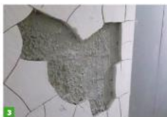
FOT. 3-4. Odparzenia tynku – widok uszkodzeń w zbliżeniu; fot.: autorzy
