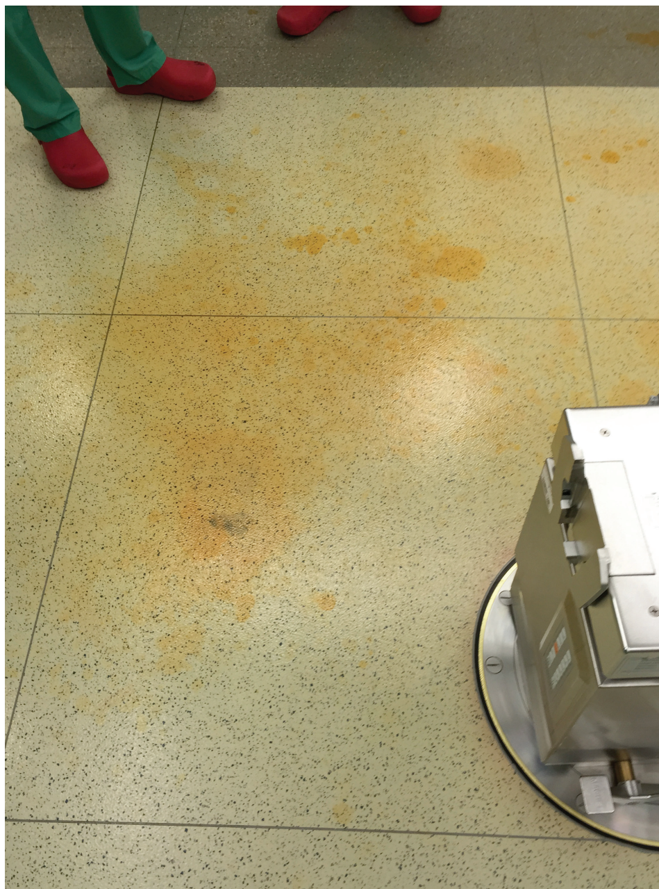
Ilustracja 6.5.4 Fragment wykładziny przy stole operacyjnym uszkodzonej przez środki dezynfekcyjne (materiały wykończeniowe powinny być dostosowane do używanych środków chemicznych), fot. autor, 2016 r.
