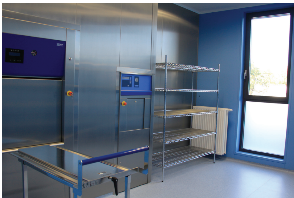
Ilustracja 6.4.3 Pomieszczenie centralnej sterylizacji (fizyczne oddzielenie części brudnej czystej i jałowej pozwala ograniczyć możliwość wtórnej kontaminacji narzędzi), fot. autor, 2016 r.
