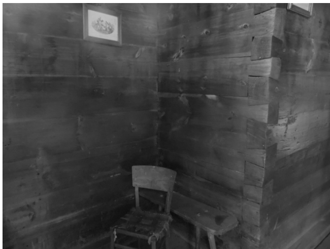
Rysunek 5. Brak pokrycia i wykończenia ścian we wnętrzu cerkwi w Chotylubiu.
