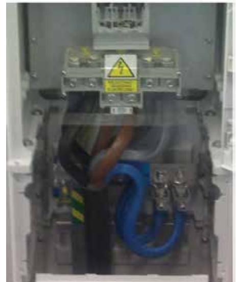
Rys. 8. Widok kabla typu YAKXS 4 x 240 mm 2 przyłączonego do zacisków rozłącznika bezpiecznikowej z przekroczeniem promienia gięcia. Źródło: archiwum M. Schwann
