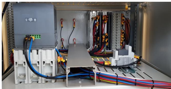
Rys. 4. Urządzenia tworzące stanowisko badawcze [3]
