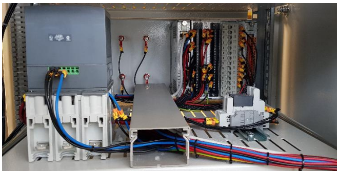
Rys. 1. Elementy składowe stanowiska badawczego, z lewej wyłącznik XT2N wraz z napędem silnikowym MOE, z tyłu przekaźnik zabezpieczeniowy REF615 (wyprowadzenia zacisków) [1]
