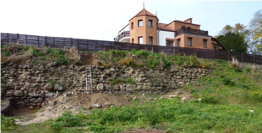
Ryc. 5 Mur skarpy przedzamcza zachodniego. Odkrywka archeologiczna po lewej stronie ukazuje głębokość posadowienia; widoczny budynek – prawdopodobna przyczyna zawalenia długiej partii muru (2017, fot. autora)
