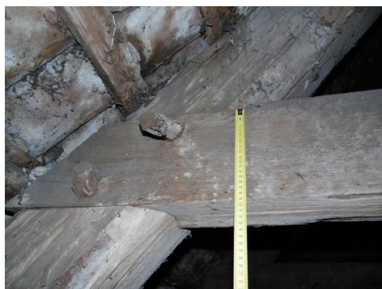
Fot. 6. Bystrze – połączenie jętki z krokwią. (fot. autor)
